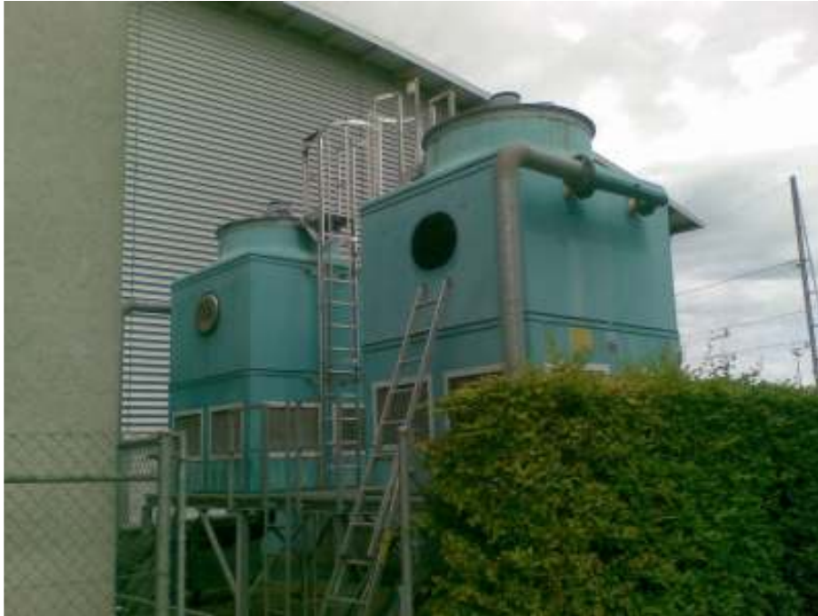
Kühlturm Nr. 1 der Eislaufbahnanlage der Stadt Frauenfeld
