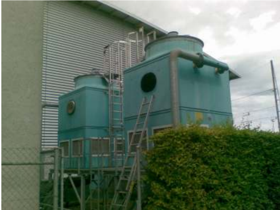
Kühlturm Nr. 1 der Eislaufbahnanlage der Stadt Frauenfeld
